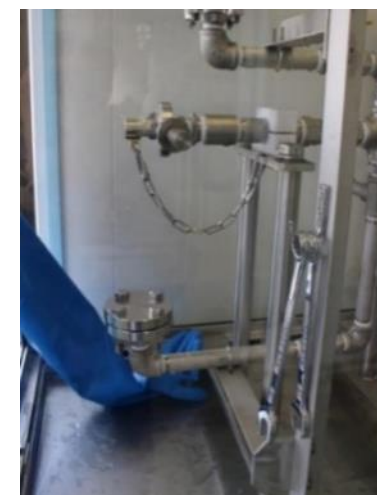
液飛散危険体感装置
