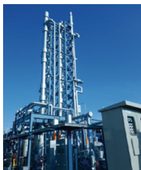
CO 2 回収実証試験設備
