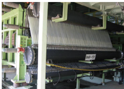
苛性ソーダの新型電解槽
