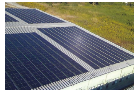
太陽光発電システム
